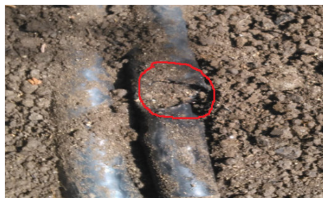
Fig.21. Vizualizarea defectului de manșon după efectuarea săpăturii
