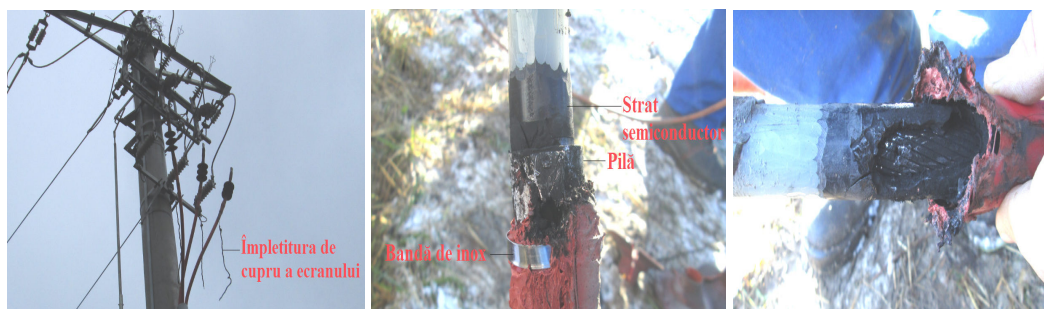
Fig.22. a)Dezlegarea ecranelor de cupru de la centura de împământare a stâlpului LEA și identificarea defectului de cap terminal;b)Înlăturarea învelișului exterior și vizualizarea în ansamblu a defectului
