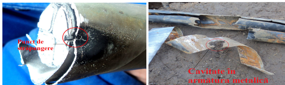
Fig.19. Punctul de străpungere a izolației dintre conductor și armătura metalică; Porțiunea din banda de oțel în care arcul electric a generat fenomenul de vibrație al armăturii metalice.
