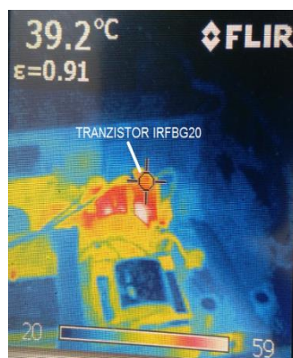
Figura 4.26. Valoarea temperaturii tranzistorului cu turațiile reduse ale ventilatorului de răcire [78]
