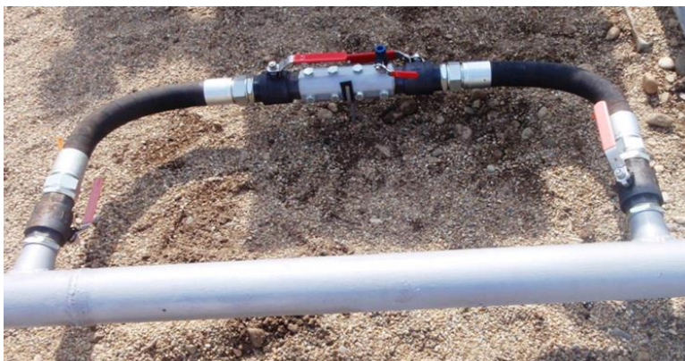
Fig.3 Dispozitiv instalat în locația nr.1
