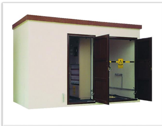
Fig. 2.6 Post de transformare 20/0,4 kV[Fotografie originală F. Nicolescu]
