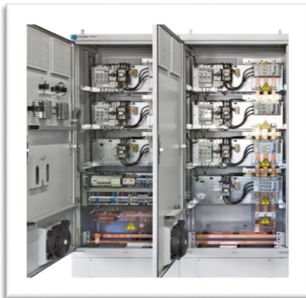
Fig. 2.11 - Baterie automată de compensare locală a energiei reactive [Fotografie originală F. Nicolescu]
