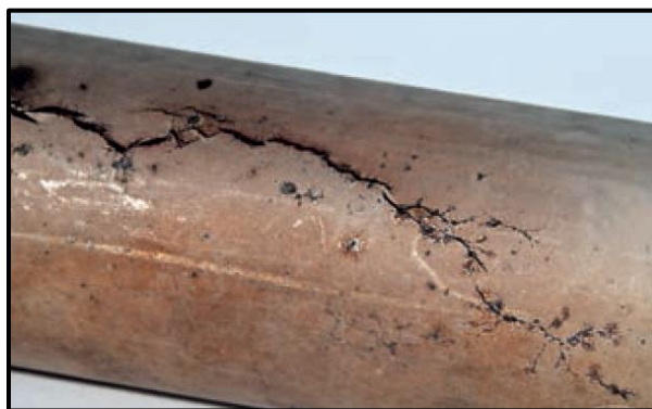
Fig. 3.1 Coroziune fisurantă sub tensiune pe o țevă din oțel inoxidabil [1]
