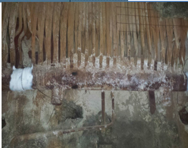
Fig.1. Zona colector-supraîncălzitor radiație cazan Grozăvești
