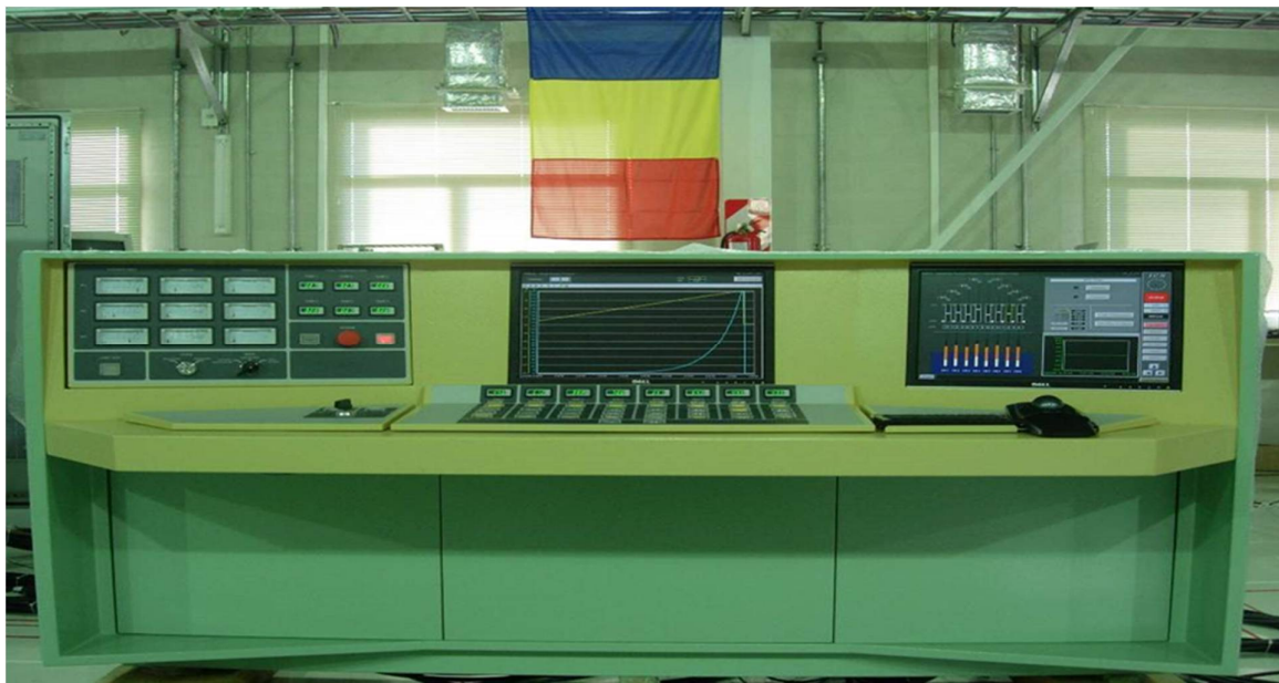
Fig. 3.15. Noua consolă de operare TRIGA SSR 14MW
