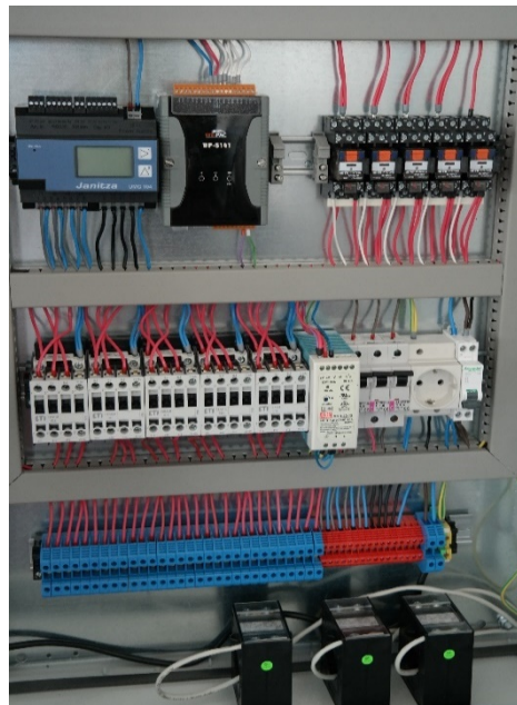
Fig.3.7. Tablou TLMC-1 cu transformatoare de măsurare de curent
