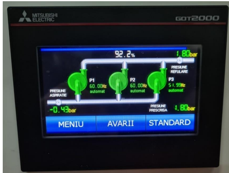
Fig. 2.27. Ecran principal cu informații despre funcționarea stației de pompare
