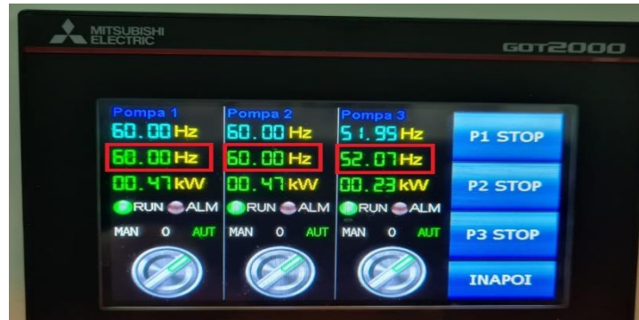
Fig. 4.5. Ecran senzorial HMI: afișarea frecvențelor f_1 \div f_3 în [Hz]; indicatorul verde RUN arată că pompele funcționează; comutatoarele (cercuri gri) sunt poziționate pe AUT (automat), deci turația pompelor este ajustată de sistemul de automatizare; dacă se optează pentru MAN (manual), atunci pompele vor funcționa cu frecvență fixă impusă/setată de operator; pentru poziția 0, pompa va fi scoasă din funcțiune (deconectată) de către operator
