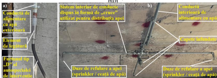
Fig. Error! No text of specified style in document.3. Instalația fixă de stingere amplasată: a) în exteriorul încăperii de testare, perpendicular pe peretele cu ușa; b) în interiorul încăperii de testare, la nivelul tavanului
