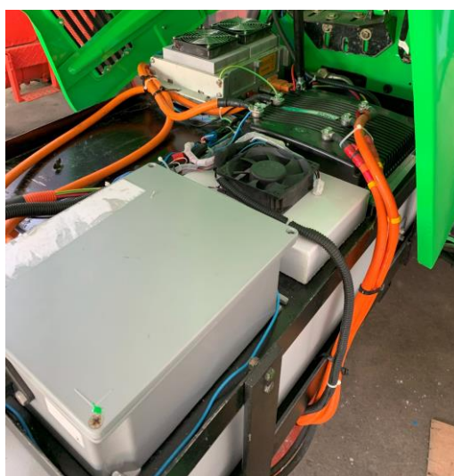
Figura 5.7 Detaliu de la montarea echipamentului electronic la tractorul electric
