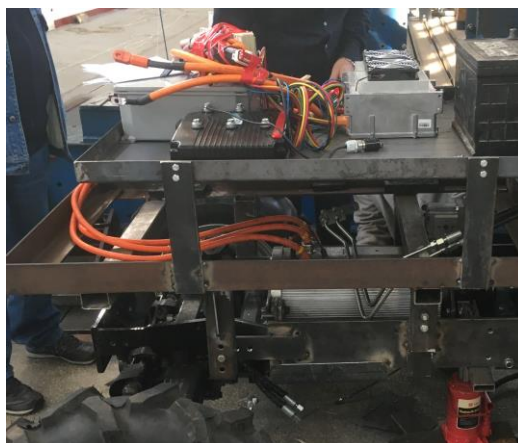
Figura 5.5 Detalii privind sistemul de montaj al bateriei și al sistemului electronic de control al motorului
