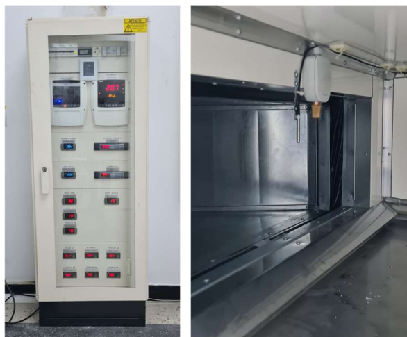
Fig. 3.5 Tabloul de monitorizare a instalației de climatizare și poziționarea senzorilor în centrala de tratare a aerului
