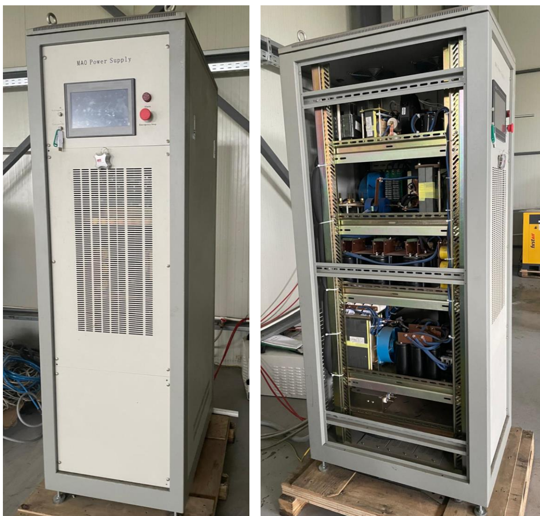
Figura 3.4. Imagini ansamblu - sursă de curent Plasma Technology pentru instalație PEO industrială
