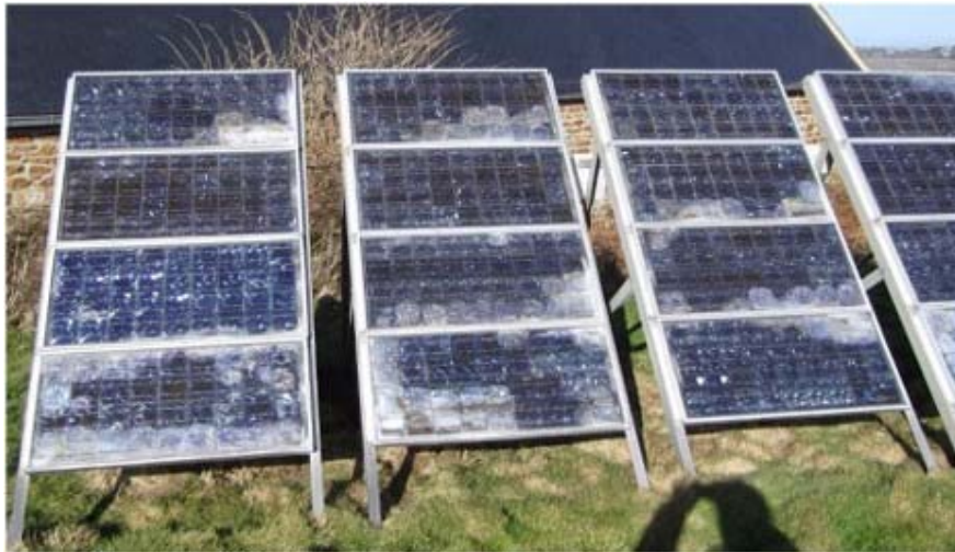
Fig. 3.1 Depuneri de sare pe suprafața panourilor PV/climat marin[5]
