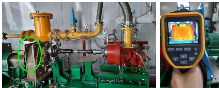
Figura 8. Locul de montare în șuruburi a modulelor TEG și scanarea termică a multiplicatorului
